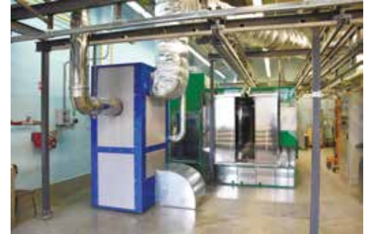
Новый газовый теплогенератор в цехе № 205
